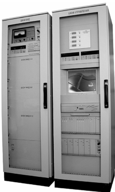
Рис. 1. Внешний вид шкафов системы автоматизации трубы Т-313.
