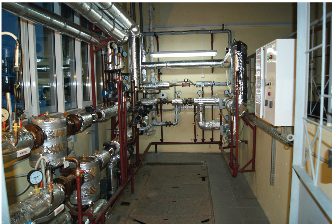
Рис. 7. Новый автоматизированный тепловой узел в здании ЦКП «Геохронология кайнозоя»
